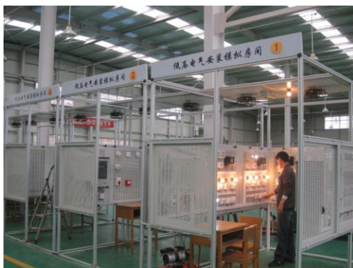
低压电气安装实训中心
