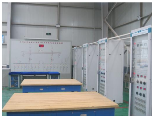
供配电综合自动化实训中心
